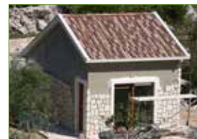
Primjeri pogrešnog oblaganja pročelja tankim kamenim pločama
